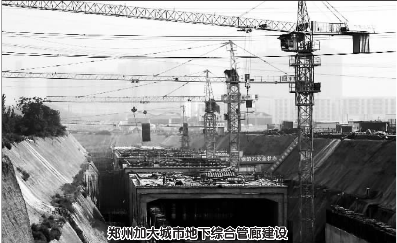
6月22日拍摄的郑州地下管廊建设施工现场。河南省郑州市是全国地下综合管廊建设试点城市之一。该市2016年开工建设的地下综合管廊项目,目前正在加紧施工。工程竣工后,供水、排水、燃气、热力、电力、通信、广播
