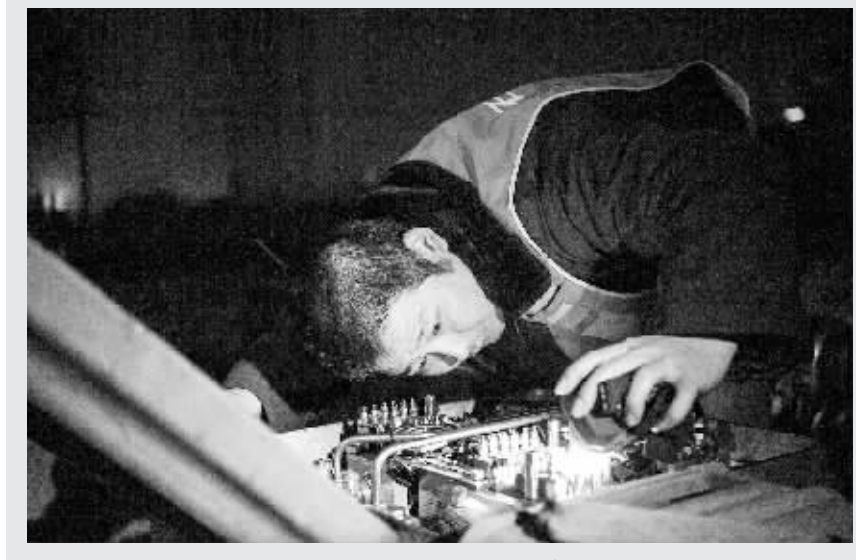
信号工正在对高铁电务信号设备进行检修。
