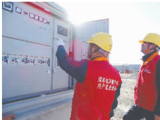
党员服务队队员检查大用户供电设备
