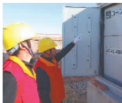
党员服务队队员对配电箱进行检修
