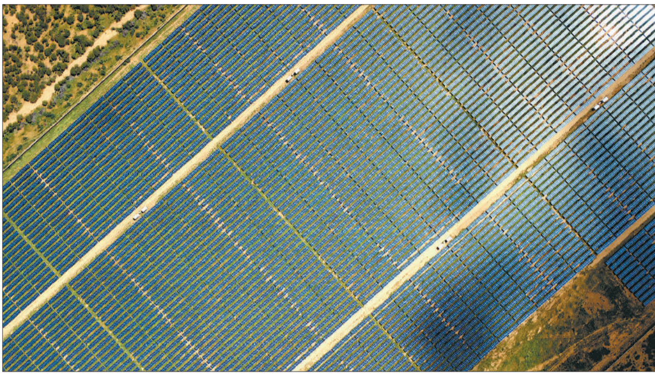
这是12月13日拍摄的肯尼亚加里萨50兆瓦光伏电站。中企承建的东非最大光伏电站肯尼亚加里萨50兆瓦光伏电站13日正式投入运行。 新华社记者 谢晗摄
