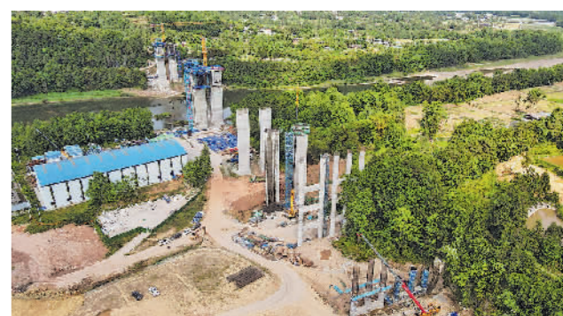
由中铁十五局五公司承建的恩阳河特大桥位于四川省巴中市恩阳区,桥长865米,最高桥墩36.5米,横跨恩阳河,是苍巴高速控制性工程之一。项目负责人贾辉表示,他们通过多种措施,在保持高效施工的同时做好环保工作。 赵越杰摄
