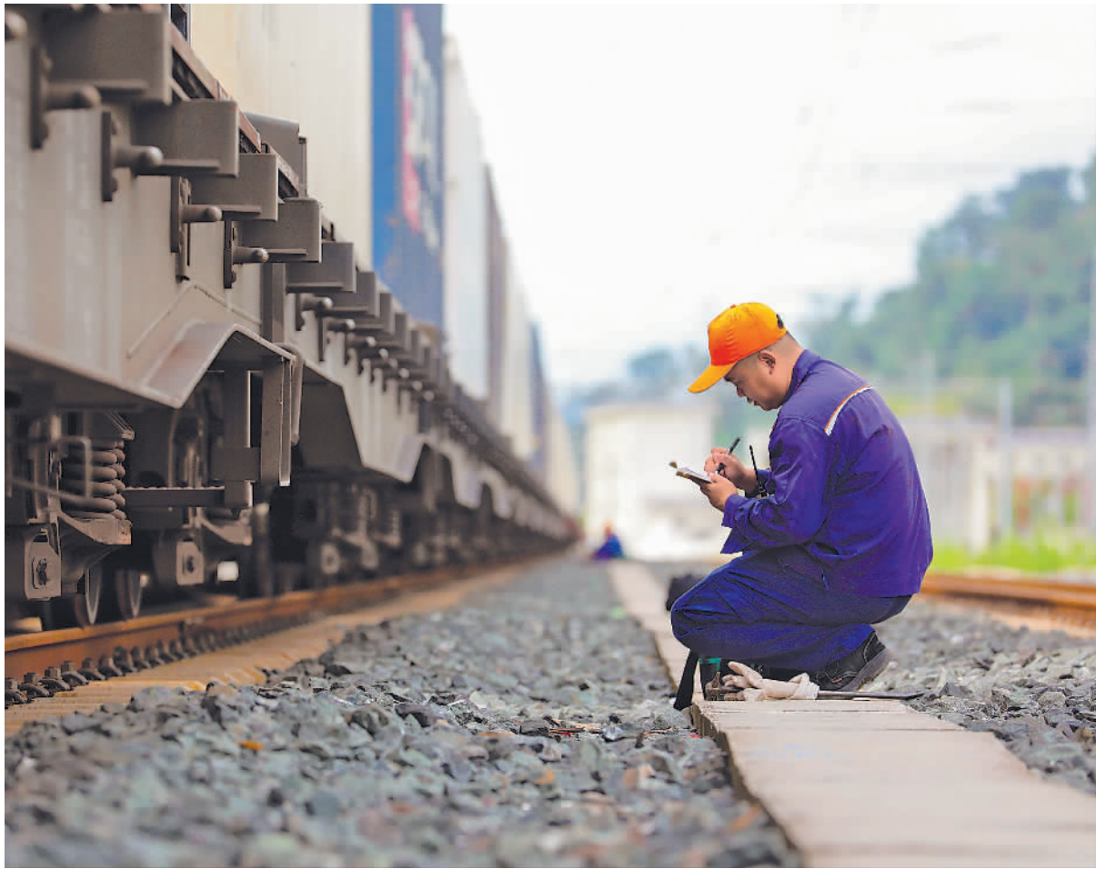
▲图为近日,在老挝磨丁口岸车站,铁路工作人员进行检查作业。
