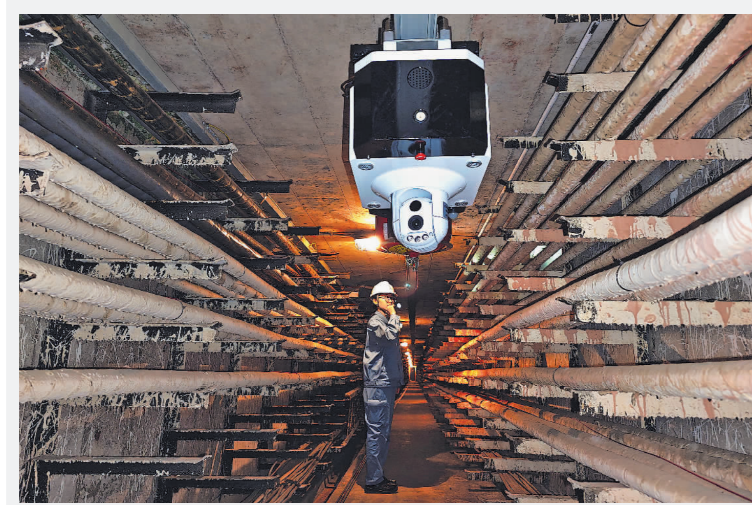
电缆隧道里的智慧卫士
